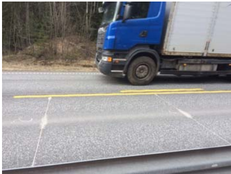
Piezo electrical cables PATK E18 Dørdal
